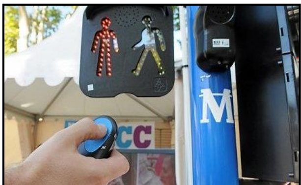
Photos 10-11 : Fonctionnement des feux sonores à partir de la télécommande universelle
