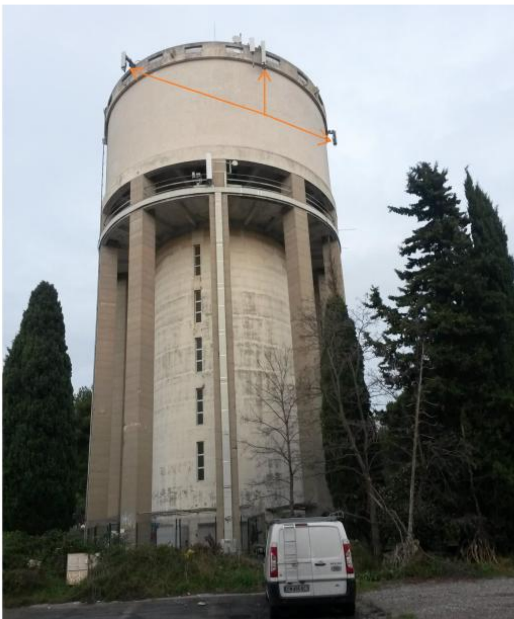
vue 2 : Vue de près ; Pas de modification visuelle après le changement des antennes.
